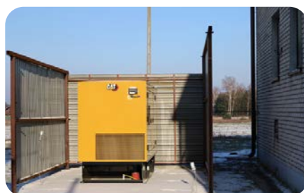
Stacja uzdatniania wody
